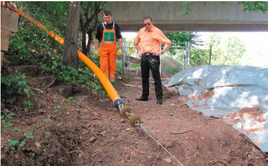
Rohreinzug im Bereich der Eisenbahnbrücke unter den Augen von Albert Stiedl, Vorarbeiter bei Diring & Scheidel und dem Geschäftsführer der Stadtwerke Eschwege GmbH, Markus Lecke.
